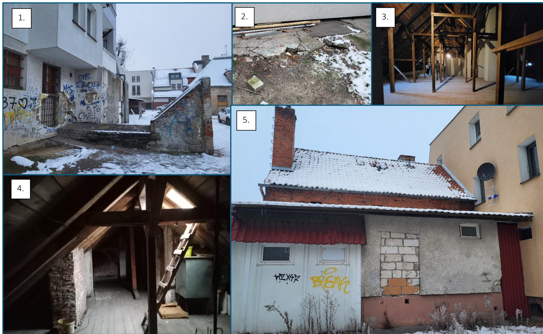
Rycina 15 Przykłady złego stanu technicznego lub niezagospodarowania obiektów zlokalizowanych na obszarze rewitalizacji – 1-2. okolice ul. 3 Maja, 3. Strych Biblioteki Miejskiej, 4. Strych Przedszkola Miejskiego Kubuś Puchatek, 5. Budynek przy ul. Andersa 1
